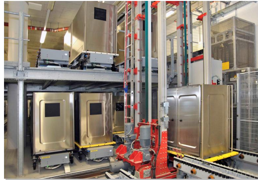
Fördertechnik im Rollcontainerspeicher
